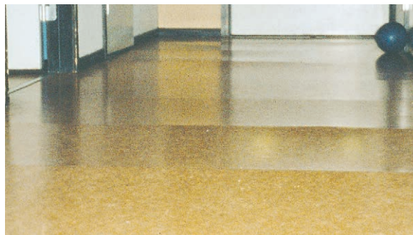
Fukt har trängt igenom den underliggande folien och har medfört att spånskivan svällt, nedbrytning av lim och blåsbildning på mattan.
