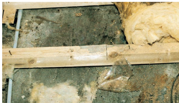
Fukt från mark har trängt igenom betongen/ plastfolien och orsakat mögeltillväxt.
